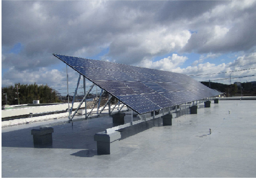
太陽光パネル
