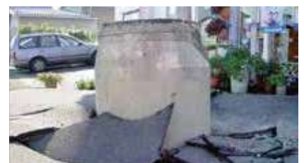
Pozo de registro que sobresale de la superficie
