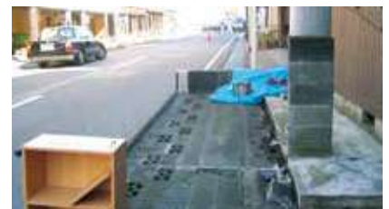
Muro de bloco tombado
