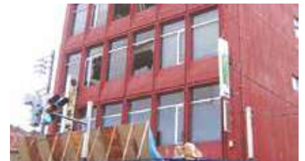
Queda dos vidros quebrados da janela
