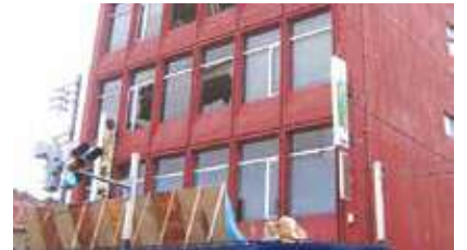
破损、掉落的窗户玻璃
