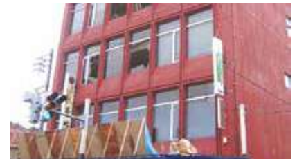
破损、掉落的窗户玻璃
