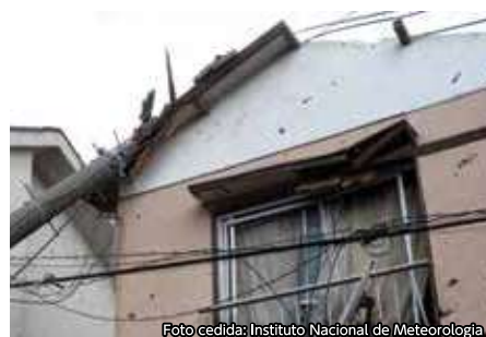
Poste cai e quebra a casa
