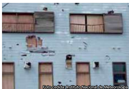
Parede quebrada por objetos arremessados
