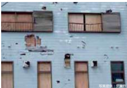
ひらいぶつ こわ かべ 飛来物で壊れた壁
