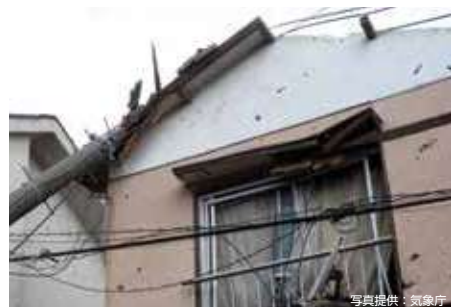
たお でんちゅう こわ いえ 倒れた電柱で壊れた家
