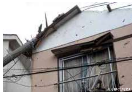
被倒塌的电线杆砸坏的房子
