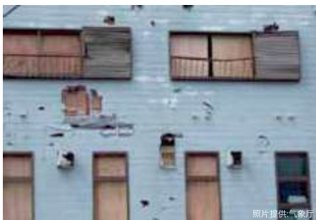
被飞来物品砸坏的墙壁
