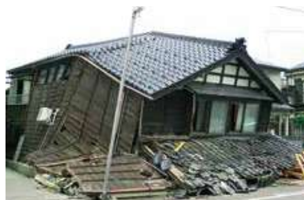
La casa se ha derruido
