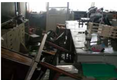
Janela quebrada da sala dos professores
