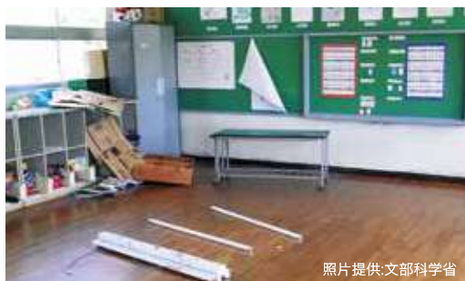
掉落的日光灯
