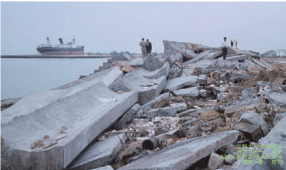
なみ さよう ていぼう いちぶ ごわ 波の作用でコンクリートでできた堤防の一部が壊れた
